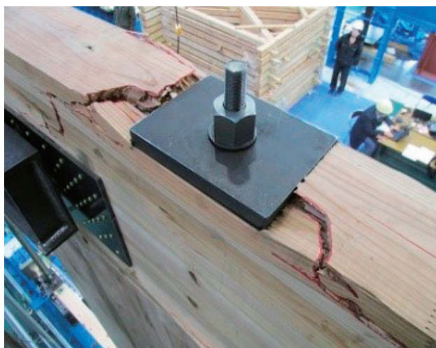
写真7 座金のめり込み
