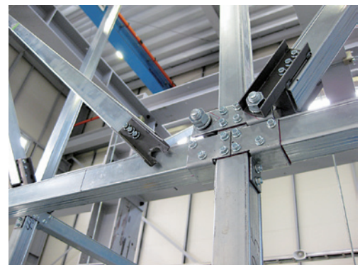
写真10 破壊状況 試験体記号：耐震スマート天井（2段）（SCS-022,023） 斜め補強材の座屈を伴う端部金物の破断
