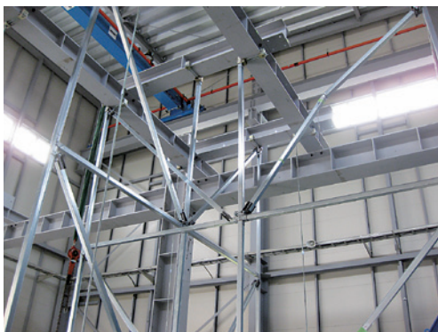
写真9 破壊状況 試験体記号：耐震スマート天井（2段）（SCS-022,023） 斜め補強材の座屈を伴う端部金物の破断
