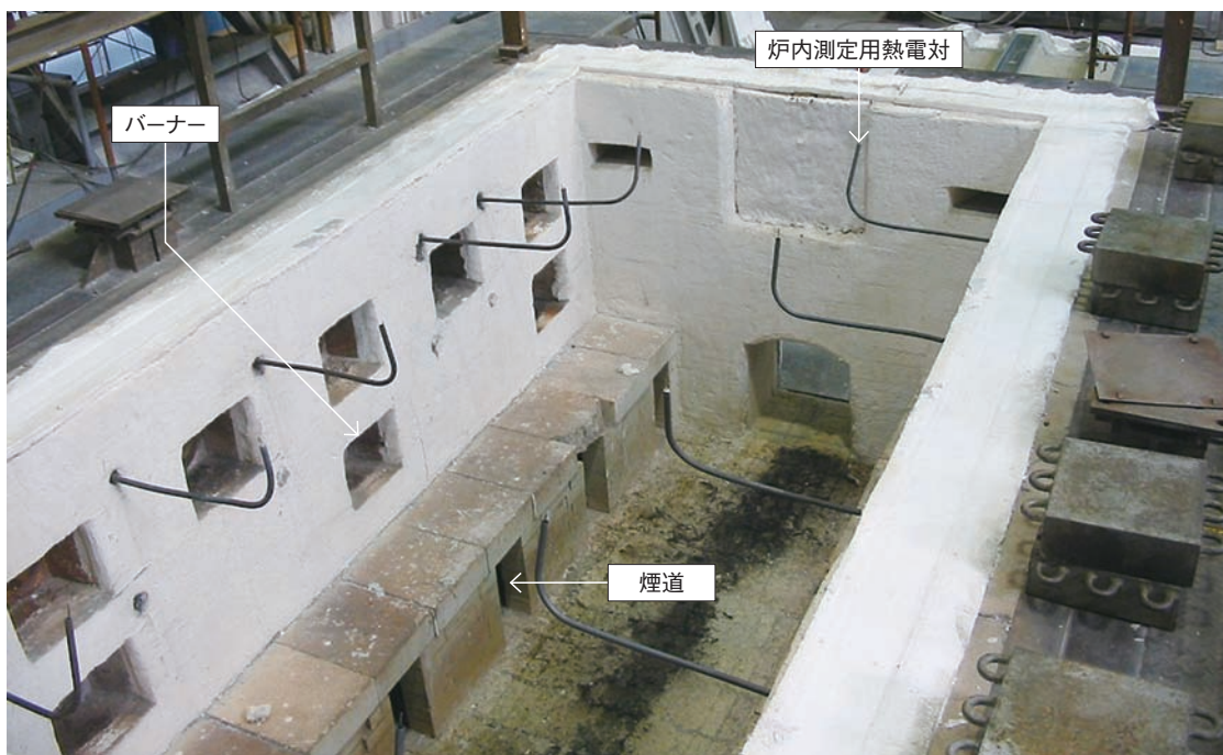
写真1 大梁炉の外観
