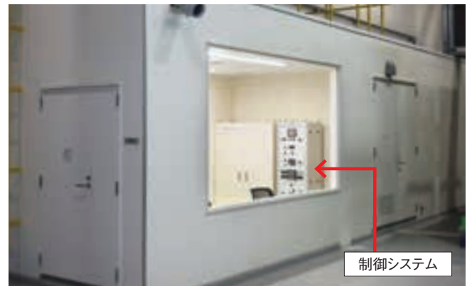
写真11 制御室(大型送風散水試験室)
