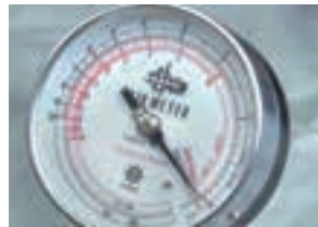
写真15 圧力計の表示
