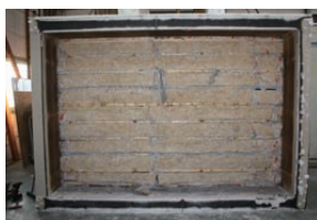
写真6 試験後の天井根太の状況
