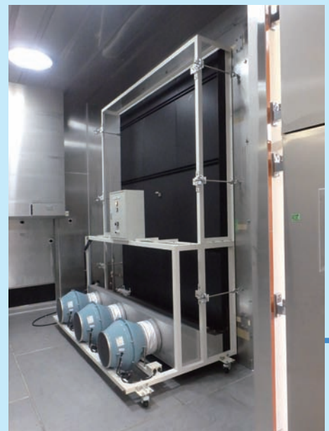
写真2 低温室内部(気流発生装置)
