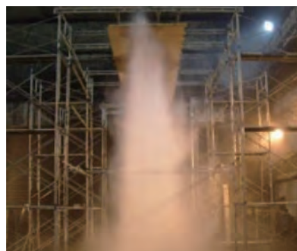
写真3 ドレンチャーシステムの事例 1)
