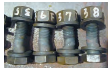
写真4 下フランジボルトの変形状況
