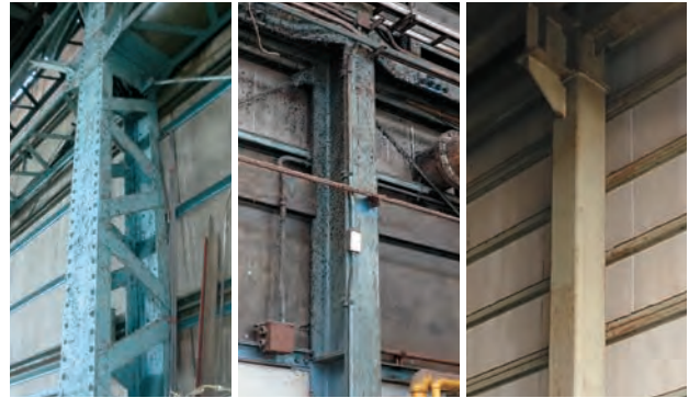
図2 建材試験センター中央試験所 防火棟内部の柱(中表紙参照) (左から組立ラチス形状柱、H形鋼柱、冷間成形角型鋼管柱)
