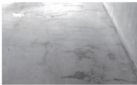
写真1 十分な均しができずに発生したひび割れ
