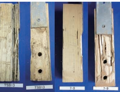
写真4 腐朽(上)とシロアリ(下)の食害例
