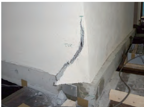
1層 X3, Y4 壁脚部でコンクリートブロックの割れ及び基礎-壁脚部間のすべり
