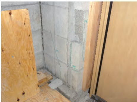
1層 X2-X3, Y1 壁脚部でコンクリートブロック及び目地の割れ
