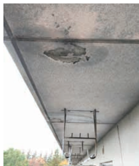
写真2 バルコニー部分の防水の劣化による漏水と仕上げの脱落
