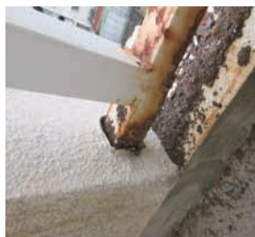
写真3 バルコニー部の鉄製手すり(接合部)の劣化
