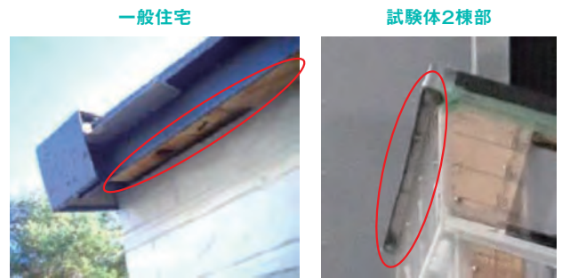
写真4 野地板裏面露出部②
