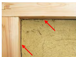
[Ⅰ] 壁土の乾燥収縮によるちりすき
