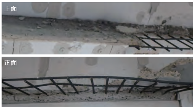
写真7 ひさし試験体の爆裂
