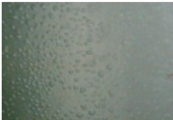
写真1 土間スラブに生じたふくれ
