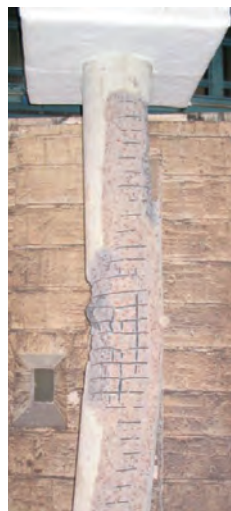
写真3 柱試験体の爆裂(甚大)
