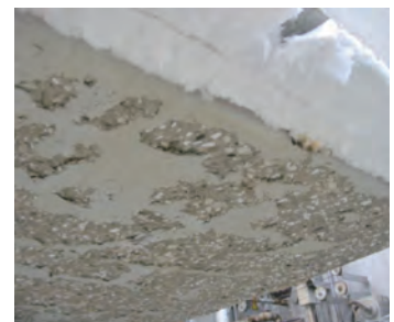
写真5 床試験体の表層剥落(軽微)
