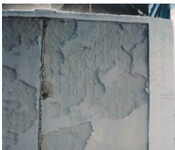
写真1 壁試験体の爆裂
