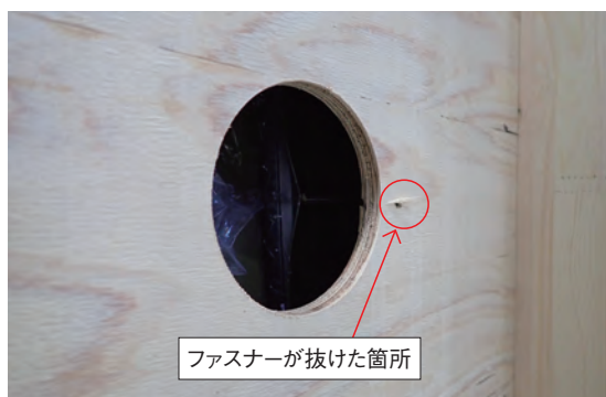
写真5 破壊状況 (試験体1)
