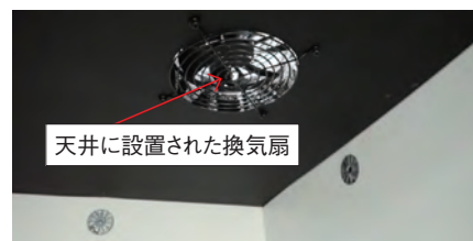
写真2 天井面設置の換気扇
