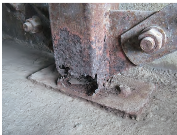
写真1 腐食による鉄骨の劣化の一例
