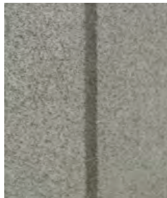
写真5 ブリージングによる仕上塗材の汚れの例
