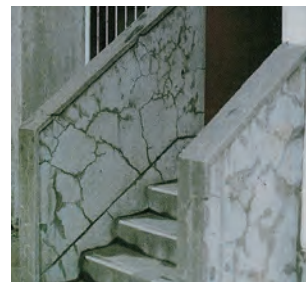
写真8 アルカリ骨材反応による 亀甲状のひび割れ
