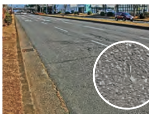
写真1 アスファルト舗装の路面に露出した骨材
