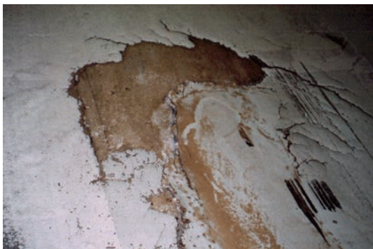
写真4 防水層までも摩耗し、下地スラブが露出
