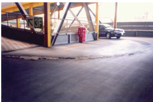
写真5 駐車場防水の損傷は車が旋回するところに多発する
