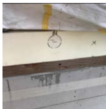
写真16 漏水センサー
