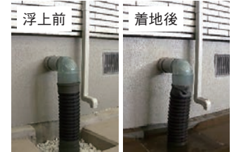
写真29 排水管接続部
