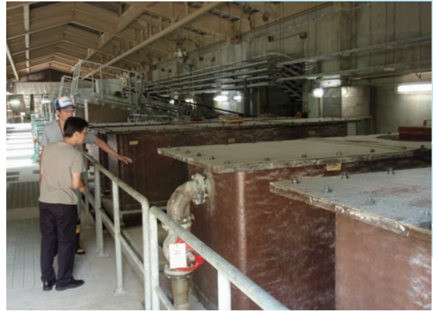
写真3 温泉水を中和するための反応槽
