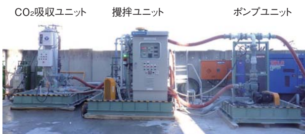
写真2 カーボキャッチ®設備外観 6)
