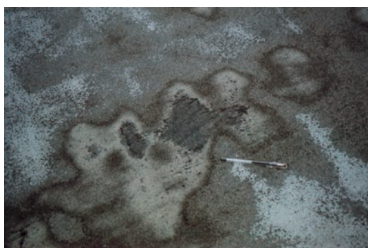
写真3 防滑層が磨滅し、防水層が露出
